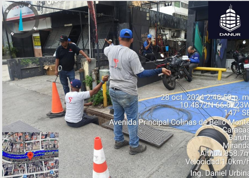
Acometidas para instalaciones a Edificaciones
